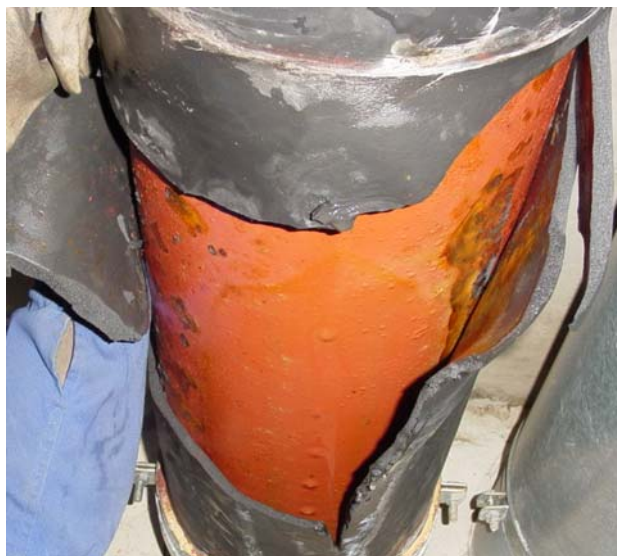
Bild 2: Kondens har bildats mellan rör och isolering eftersom fogarna limmats bristfälligt.
